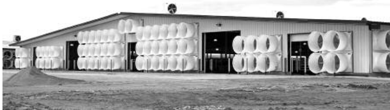
شکل ۱. یک سیستم تهویه ترکیبی با نصب فن‌ها در دیوار انتهایی برای تابستان و نصب فن‌های کلاهدار برای زمستان
